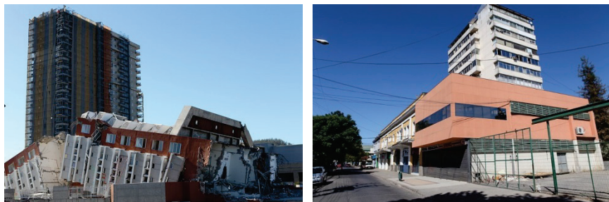
Рис. 115. Здания в Чили, построенные без учета сейсмоопасности (слева) и по сейсмостойчивым технологиям (справа), после 8,8-балльного землетрясения 27 февраля 2010 г. Автор: Walter Mooney, U. S. Geological Survey
